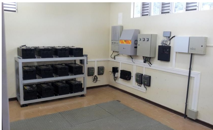
Figura 13: Disposição dos inversores, medidores de energia, quadro de comando e banco de baterias do sistema fotovoltaico na subestação Fazenda Iguaçu.
