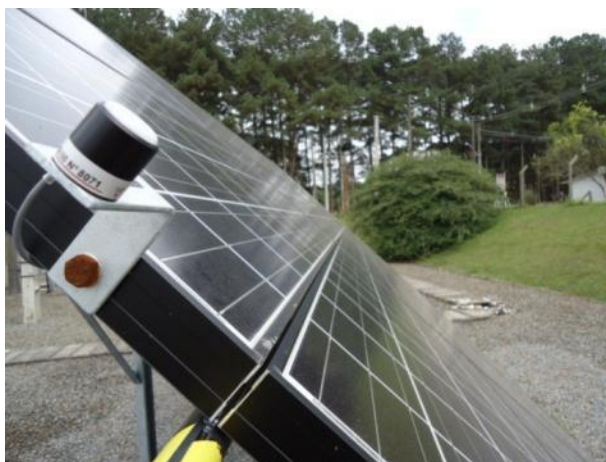
Figura 2: Sensor de radiação instalado nos painéis.
