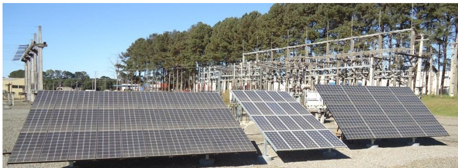
Figura 14: Painéis fotovoltaicos da planta solar.
