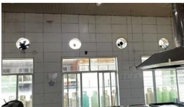
Figura 6. Teto e exaustores presentes na área da cozinha onde ficam as caldeiras
