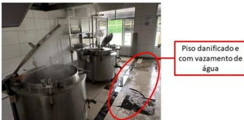
Figura 7. Piso molhado e danificado pela falta de ralo logo abaixo do escape de água das caldeiras.
