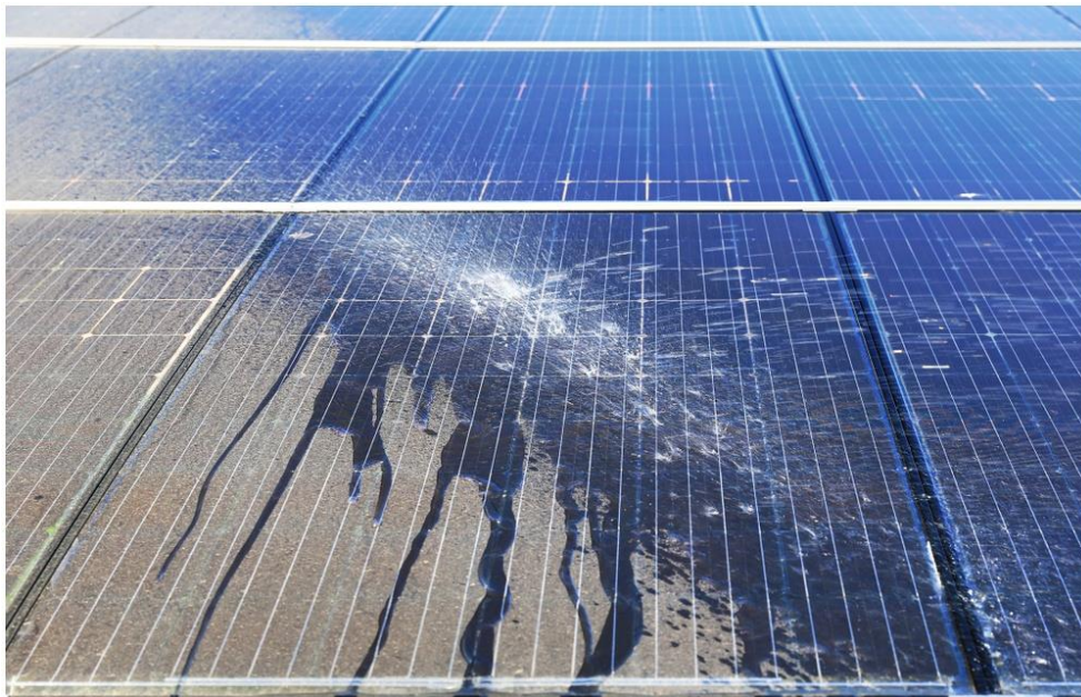
Figura 5- limpeza periódica do painel solar
