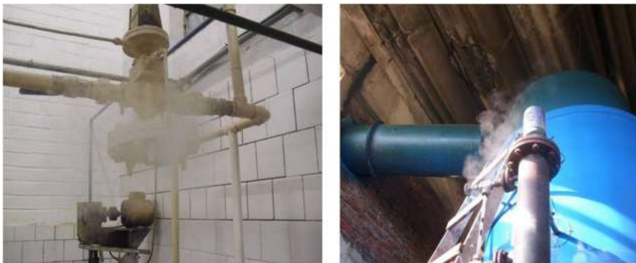
Figura 4 – Perdas de vapor na pasteurização do leite e próximo a caldeira
