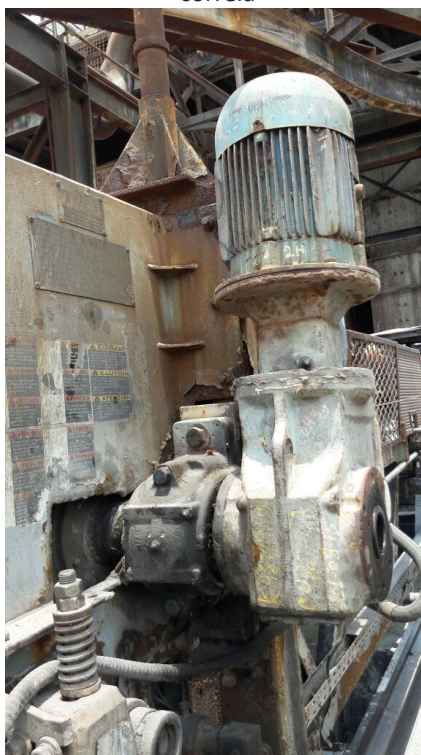
Figura 4 – Motoredutor KA87/T AM132S/M instalado em uma dos transportadores de correia
