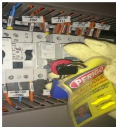
Figura 02: Inserção de dispositivo de bloqueio do disjuntor com cadeado e sinalização.
