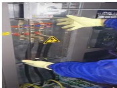
Figura 01: Inserção de proteção nas áreas energizadas.
