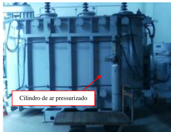
Imagem 2 – Transformador de 15.700l vazio e pressurizado
