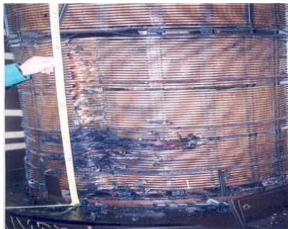
Imagem 8 – Curto circuito em bobinas gerado por arco
