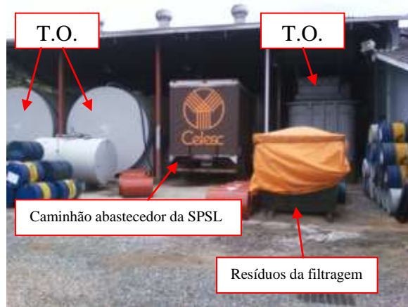
Imagem 4 – Detalhes armazenamento e transporte de óleo
