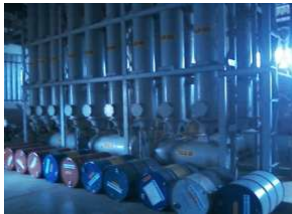
Imagem 5 - Torres de filtragem
