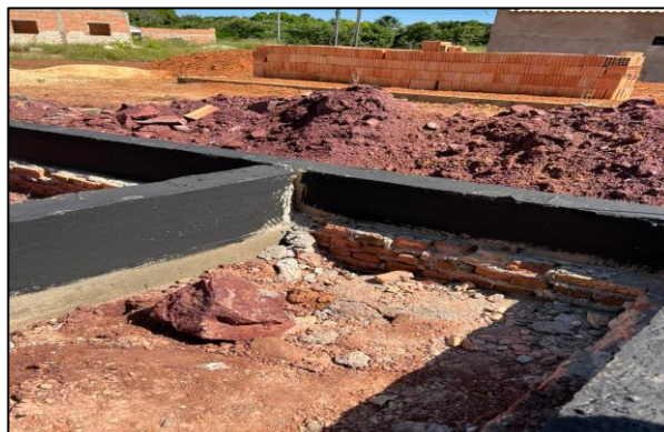
Figura 8 - Impermeabilização a ser refeita e alvenaria com assentamento irregular.
