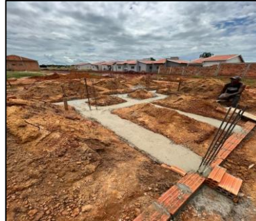
Figura 27 - Excesso de concretagem no lastro magro.
