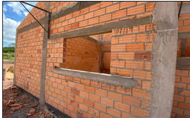
Figura 13 - Esquecimento de executar contraverga na janela lateral
