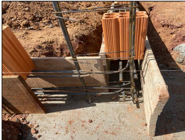
Figura 6 - Erro de Ancoragem.
