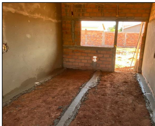
Figura 38 - Excesso de concreto para altura do contrapiso
