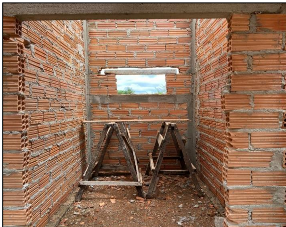
Figura 9 - Banheiro sem passagem hidráulica e elétrica/Esquecimento de verga da janela.
