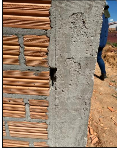
Figura 15 - Pilar com falha na concretagem.
