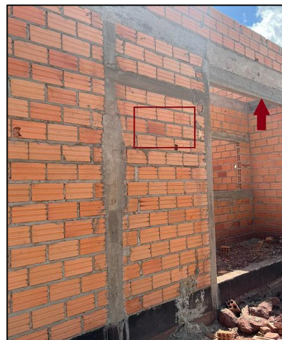
Figura 16 - Viga duplicada / Janela não executada.
