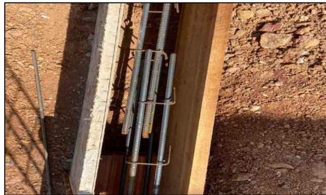
Figura 7 - Transpasse executado em discordância com o projeto.
