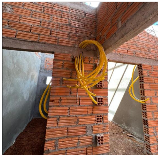
Figura 10 - Viga quebrada para passagem de sistema elétrico.
