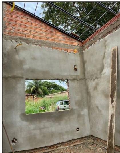
Figura 18 - Reboco com parede úmida
