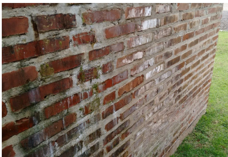
Figura 5 – Ocorrência de Patologias nas alvenarias do Protótipo 4
