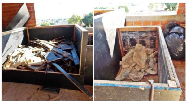
Figura 3 – Baias para resíduos provenientes de madeira e papelão.
