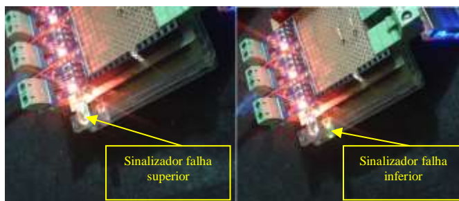
Fig. 15. Alarmes visuais sinalizadores de falha
